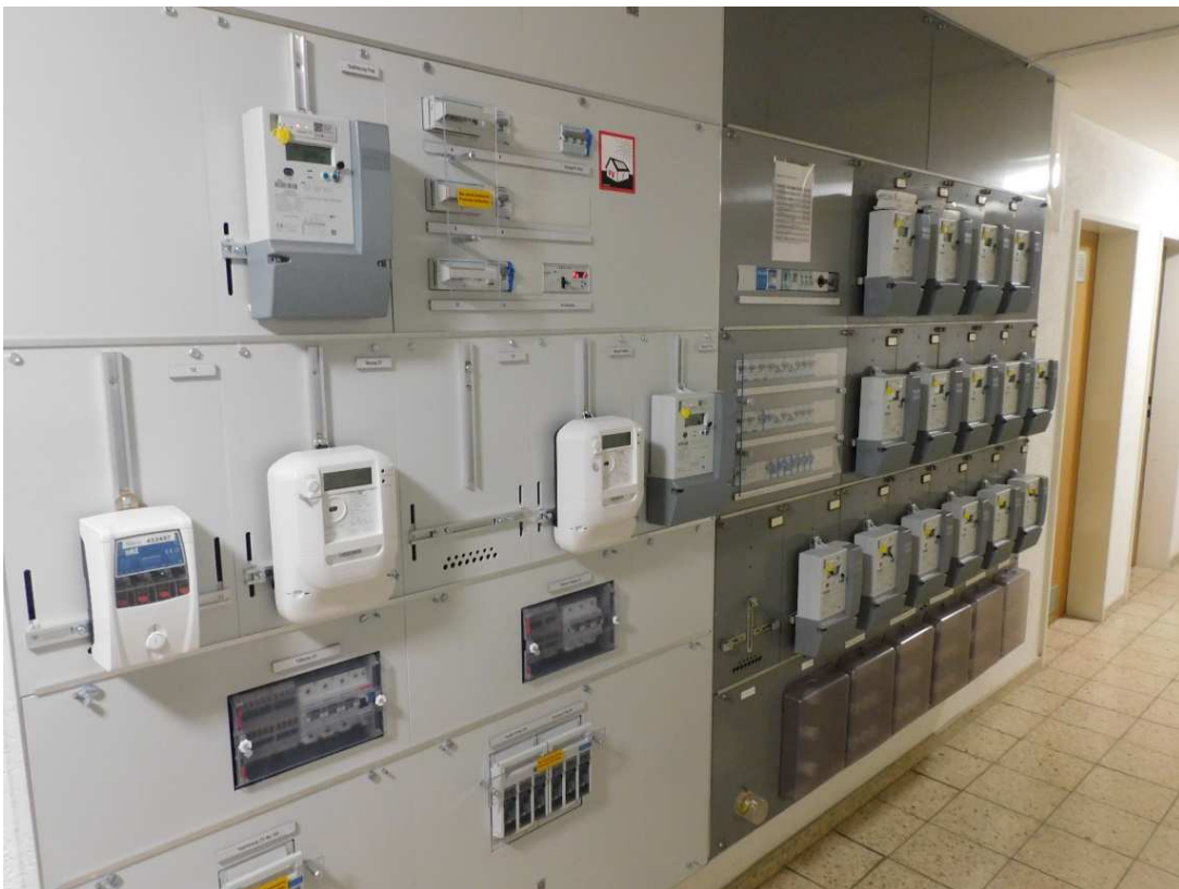
Links: Schalttafel Rechts: Stromzähler der einzelnen Mieter
