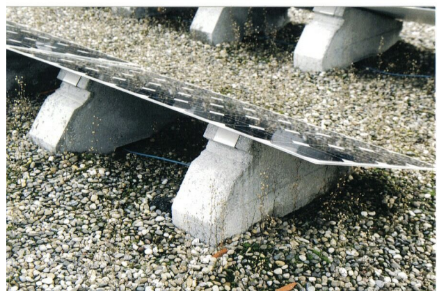
Aufständerung SOFREL N95 mit Schnell-Montage-Vorrichtung
