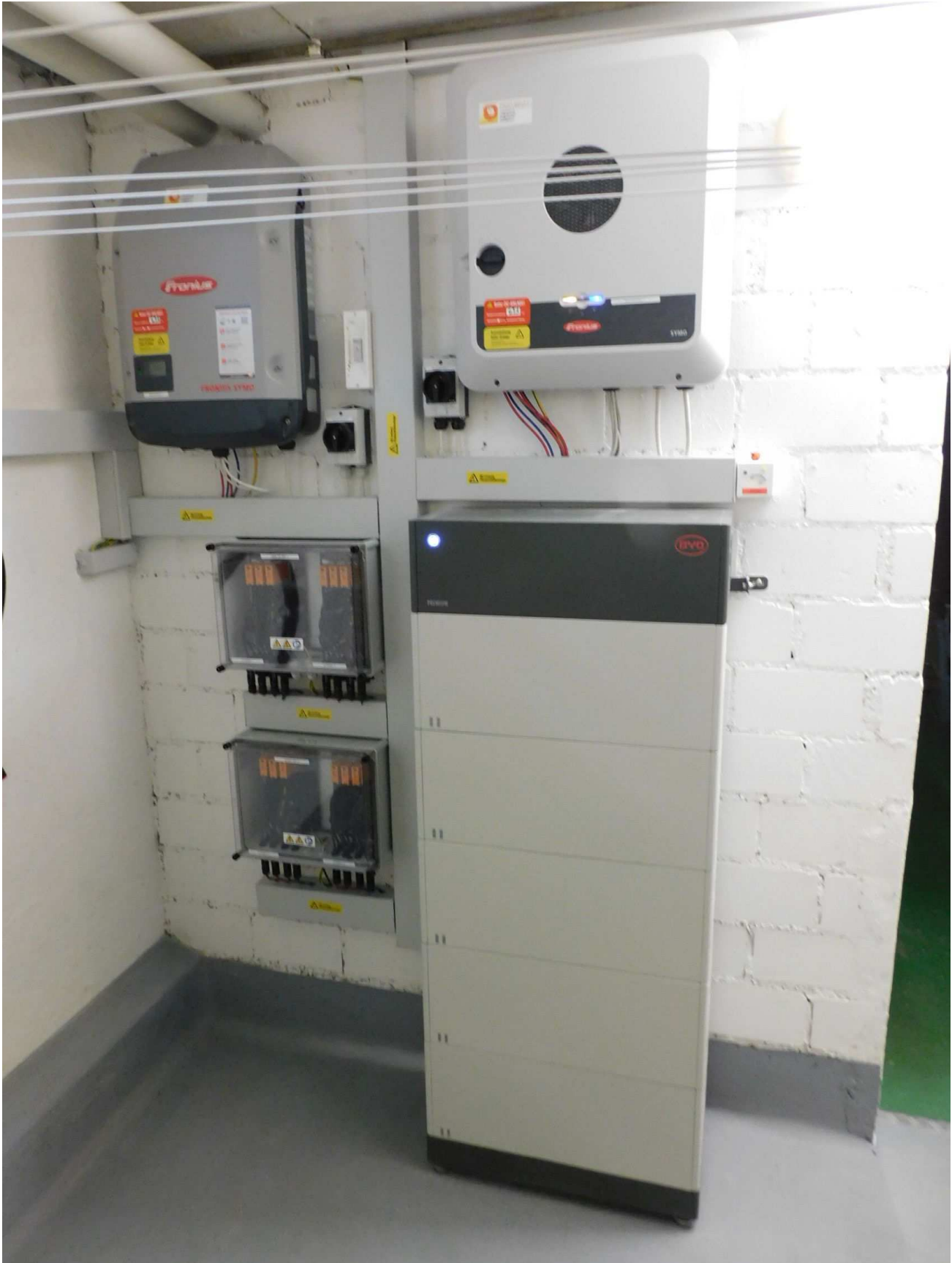
Oben links: Wechselrichter Fronius Symo 8,2-3-M Oben rechts: Hybrid-Wechselrichter Fronius Symo GEN 24 8.0 Plus Unten rechts: Batteriespeicher BYD B-Box HVM 13.8
