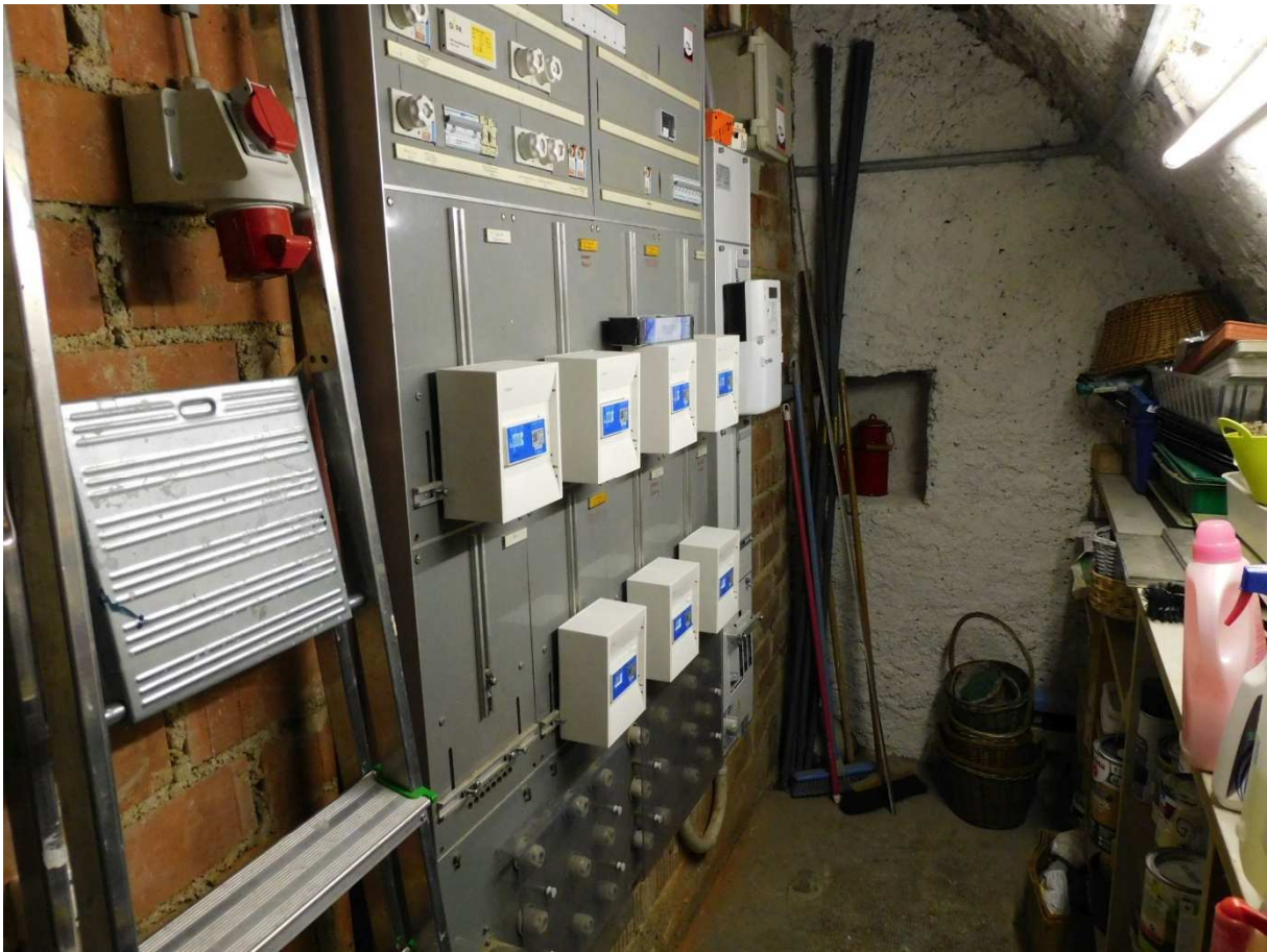
Schalttafel mit Stromzähler der einzelnen Mieter
