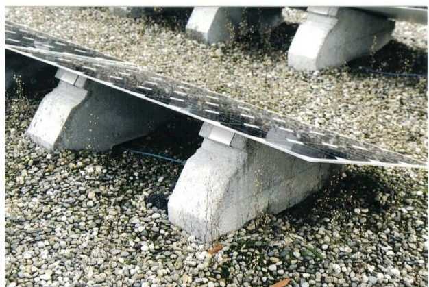
Aufständerung SOFREL N95 mit Schnell-Montage-Vorrichtung
